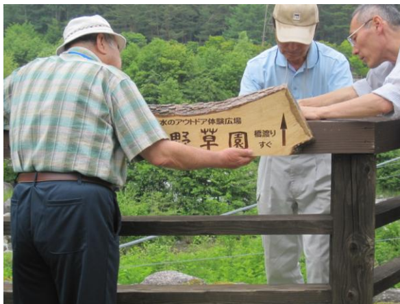
こまくさ橋南側の渡り始める 左側に2枚目を設置する様子
